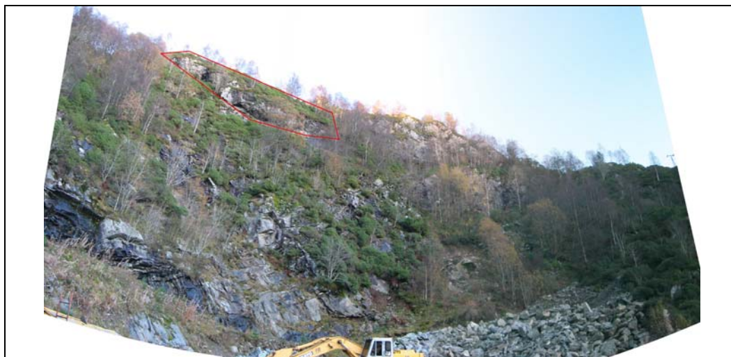
Figur 8. Oversikt østre del av den NNV-SSØ orienterte skråningen. Rød markering angir potensielt steinskred, også vist på Figur 6. Merk at bildet er fordreid da det er satt sammen av flere foto tatt fra samme posisjon.
