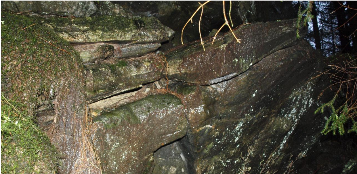
Fig 11. Lagdeling og foliasjon medvirket til sprekkeretning i ulike retninger.
