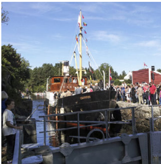
Istandsetting av portane ved Lindås sjøsluser, offisiell opning av anlegget i august. Foto: Stein Ottosen
