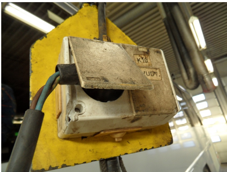
Bilde 4.11: Tilgriset stikkontakter i verksteder. Fungerer etter hensikt og har tilfredsstillende avdekning. En av stikkontaktene i verkstedet hadde ikke tilfredsstillende kapslingsgrad(knust).
