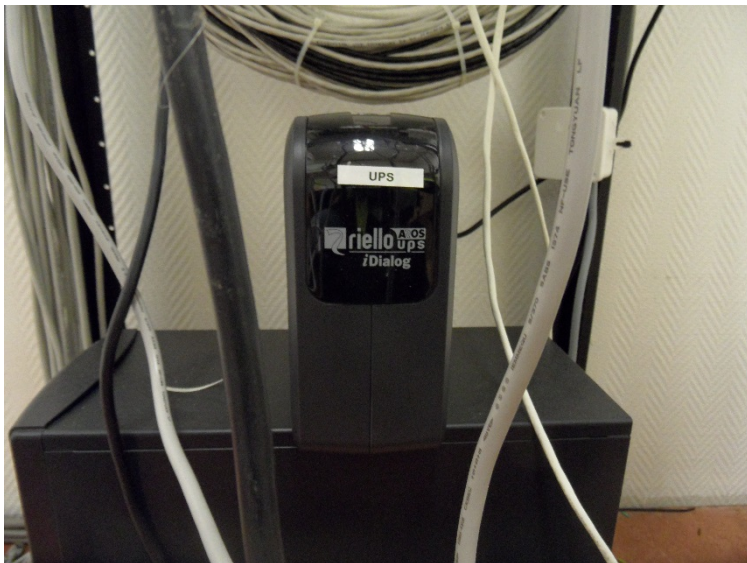
Bilde 4.25: Lokal UPS backup for kontrollert nedkjøring av lokalt nettverk (ved ett eventuelt strømbrudd).
