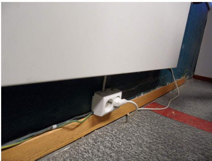
Bilde 4.2: Det er fremlagt separat jordingsleder til enkelte jordete stikkontakter (bl.a. i lokalene til veteranbussklubben).
