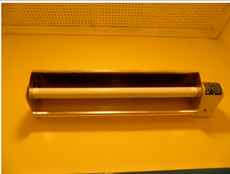
Bilde 4.21: I mindre rom er det benyttet reflektorovner. Styres fra trinnbryter. Ingen enøk styring i form av termostat.
