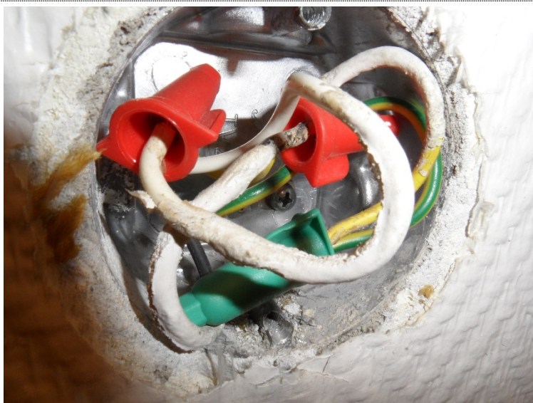
Bilde 4.9: Koblingsboks i vegg mangler lokk (i spiserom, 2.etg). Det anbefales wago klemmer fremfor vrihylser.
