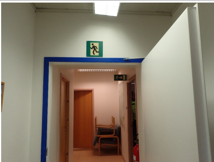
Bilde 4.33: Rømningsdører og vindu er merket med etterlysende skilt. Det er ingen nødlysanlegg installert på bygget.
