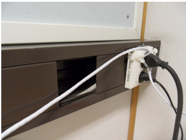
Bilde 4.7: De fleste stikkontakter i bygget er i god stand og fungerer etter hensikt. Stikkontakt som er løsnet fra feste i kabelkanal må festes.
