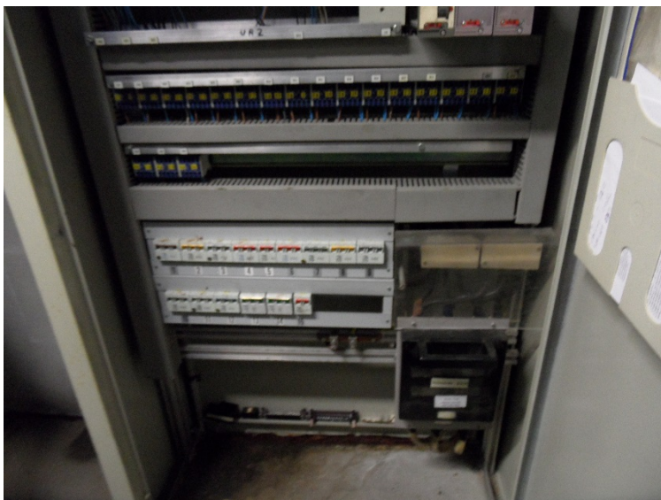
Bilde 4.14: Automatikkavle i kjeller er i normal god stand og har automatsikringer.
