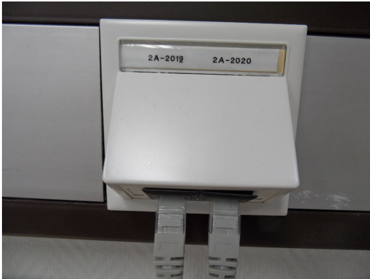
Bilde 4.28: Faste uttak for tele/data ved arbeidsplasser.
