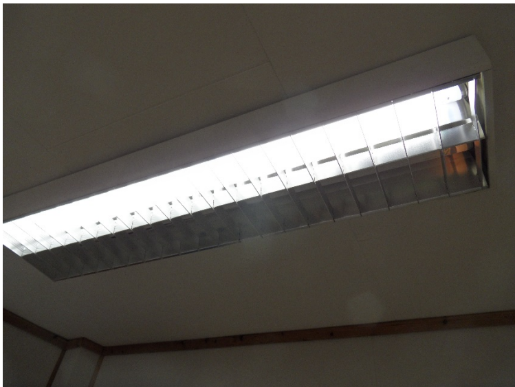
Bilde 4.16: Defekte lysrør i enkelte lysarmatur.
