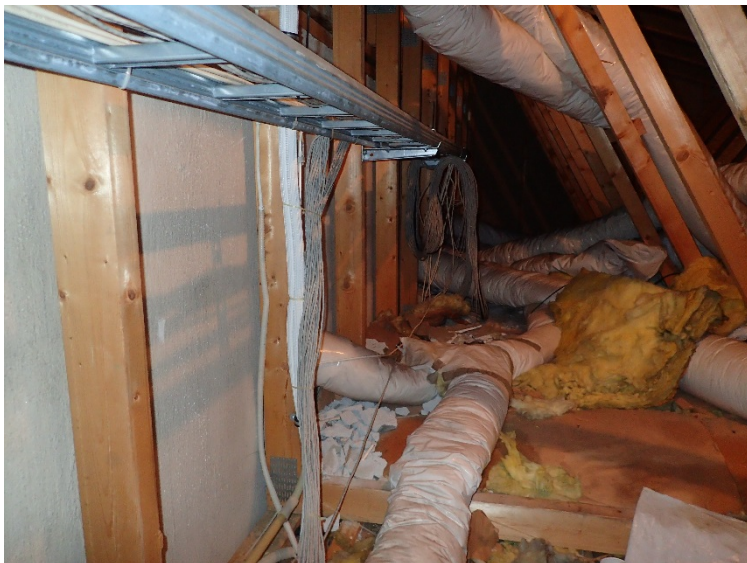
Bilde 4.1: Kabler er forlagt på kabelstiger, i kabelkanaler, som skjult og åpen installasjon. Føringsveiene på loft er noe overfylte.
