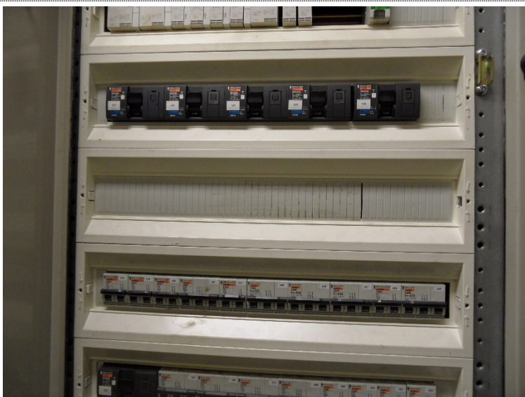
Bilde 4.3: Byggets hovedtavle er lokalisert i egen branncelle i tilknytning til verksted. Er nylig oppgradert (ca. 2008) og er i god stand. Noe støv på enkelte komponenter, trolig fra ubehandlet murvegg.
