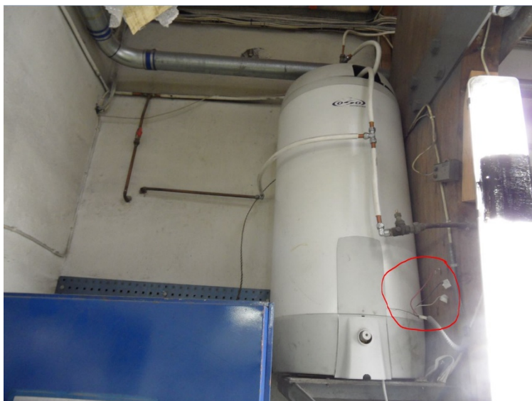
Bilde 4.8: Løse kabler må avsluttes fagmessig. Her ved en av VVB i verksted.
