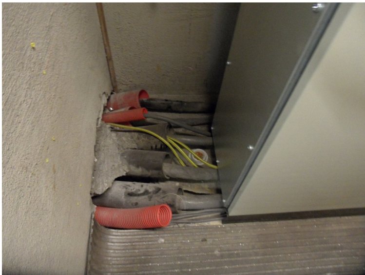
Bilde 4.4: Det mangler fagmessig brannetting rundt gjennomføringer i brannvegg ut fra hovedtavlerom.
