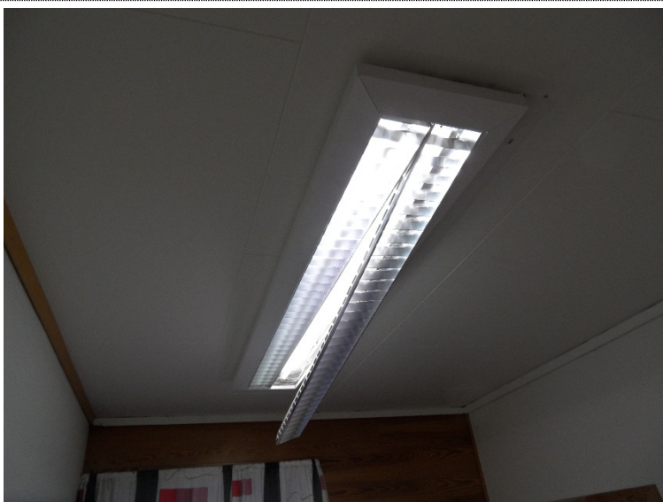
Bilde 4.17: Løs avdekning/rast på lysarmatur i 1.etg.
