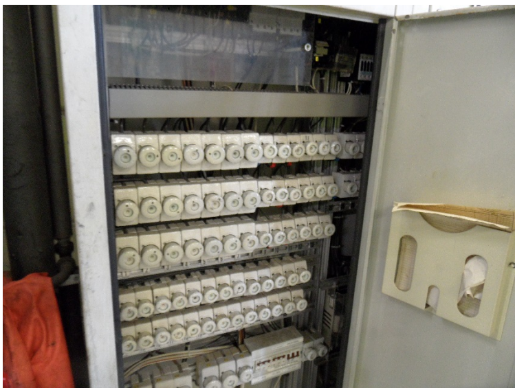
Bilde 4.5: Typisk underfordeling i hovedbygg. Med skrusikringer og har passert teknisk levealder. I følge driftspersonell er det kun en underfordeling som er oppgradert i den senere tid med automatsikringer.
