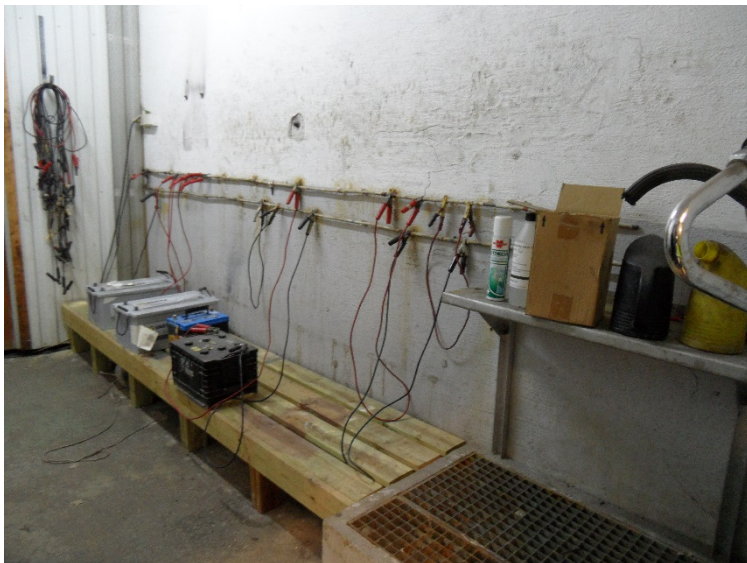
Bilde 4.13: Nye batterier (for buss) mellomlagres midlertidig og lades opp i eget batteri rom (egen branncelle) i tilknytning til verksted.
