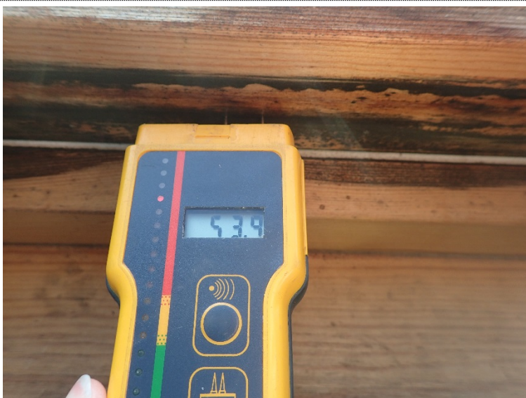
Bilde 2.11: Fukt og begynnende råteskade.
