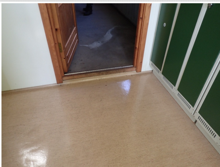
Bilde 2.15: Lite slitasje på gulvbelegg.
