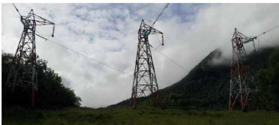
Figur 2.4. Eksempel på 132 kV fjordspenmaster.
