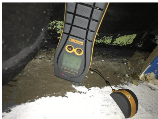
Det ble registrert unormalt fuktnivå i gulv ved yttervegg
