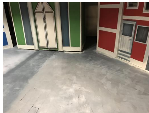
Vinylfliser er løsnet fra gulvspon-platene
