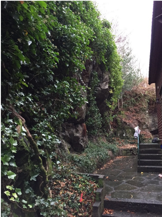
Figur 15 Skrent ved Holmedalen 12.
