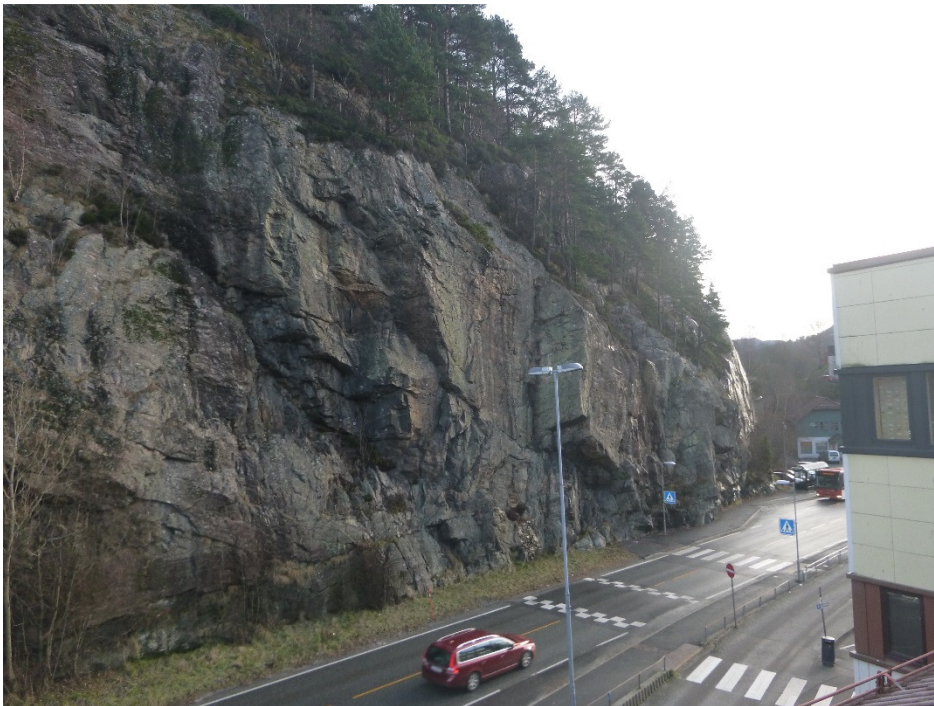
Figur 23 Fjellskrent på ca 25 meter øst for Kleppestø Senter.
