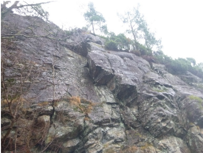
Figur 18 Overheng ved parkeringsplass.
