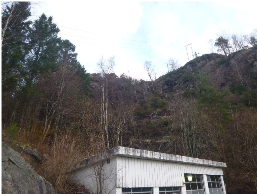
Figur 29 Skråning bak (antatt) lagerbygg, nord-øst på parkeringsplass.
