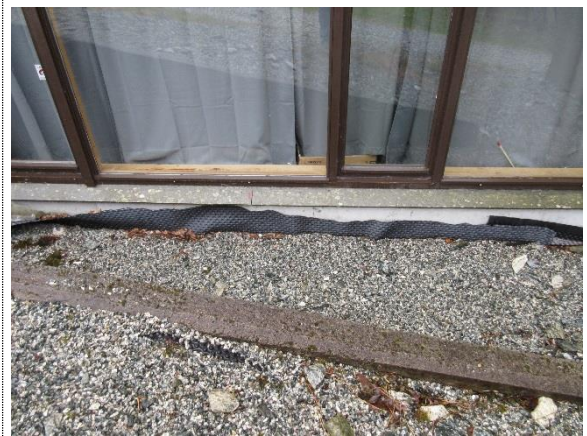
Bilde nr. 4 Grunnmursplaten er ikke korrekt festet.
