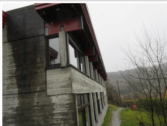
Bilde nr. 19 Gavlvegg er våt pga. mangelfullt utformet gesimsbeslag.
