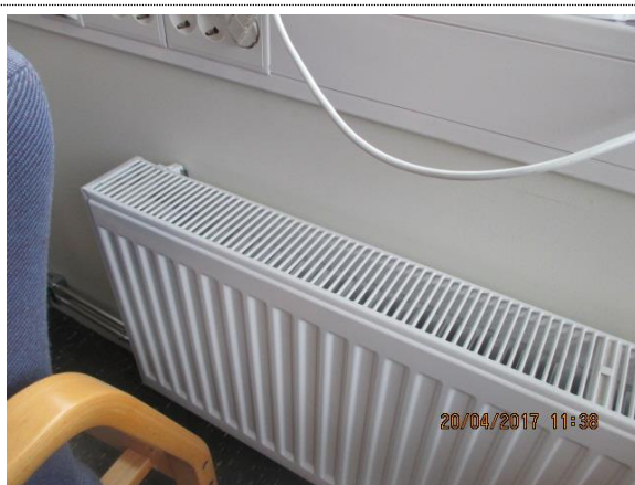
Bilde nr. 15 Moderne, vannbårent varmeanlegg i bygget.
