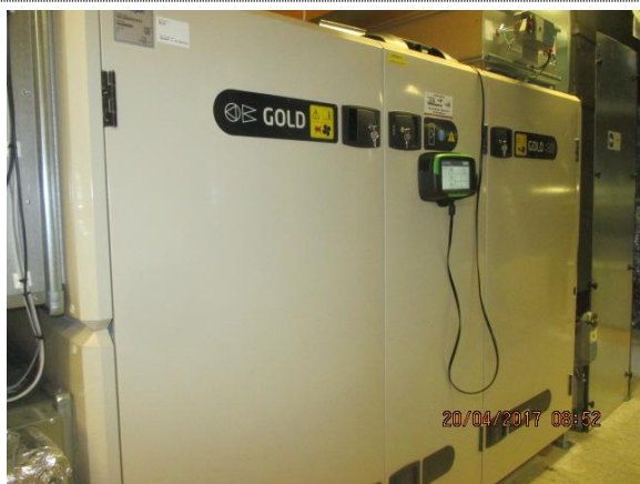
Bilde nr. 29 Nytt luftbehandlingsanlegg tilknyttet underdimensjonerte kanaler og ventiler.
