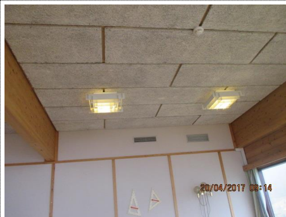
Bilde nr. 30 Underdimensjonerte kanaler og ventiler.
