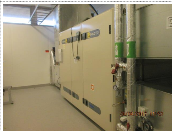
Bilde nr. 16 Moderne balansert ventilasjon.
