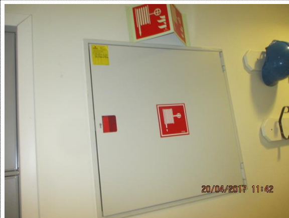
Bilde nr. 18 Strategisk utplasserte brannslanger og håndslukkere.
