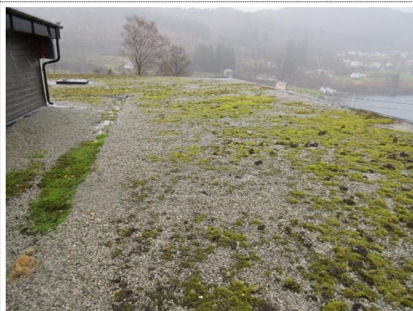
Bilde nr. 23 Generelt gammel tekking på takene, men ballastsingel fra byggeåret. Mye mosevekst.
