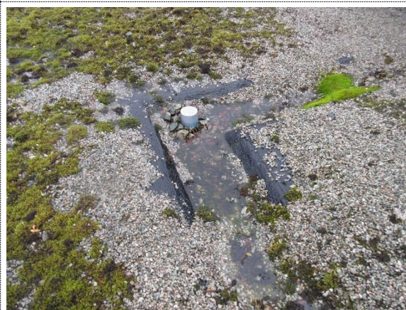
Bilde nr. 24 Taket er mange steder forsøkt utbedret med smøremembran.
