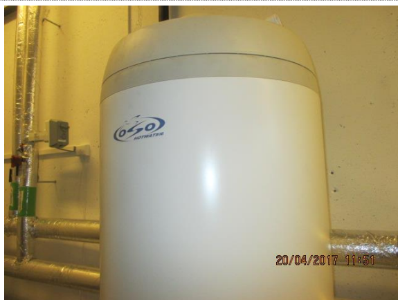
Bilde nr. 17 Varmtvannsbereider fra byggeåret tilkoblet varmepumpene.
