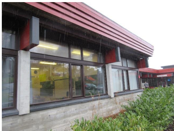
Bilde nr. 5 Mye ubehandlet betong i fasadene.
