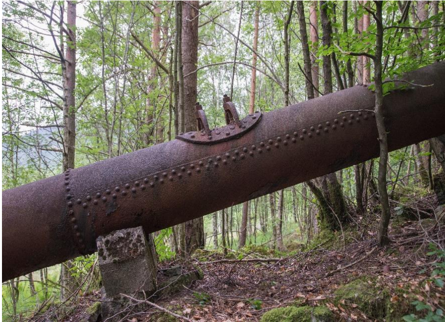
Røyrgate 1 på fundament ca. 150 meter over kraftstasjon 1. Klinka stålrøyr. Foto: Harald Hognerud/NVIM. VKf-012
