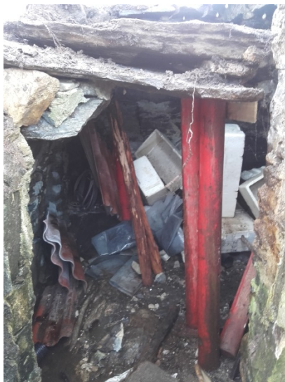
Takheller støttet opp med stokker
