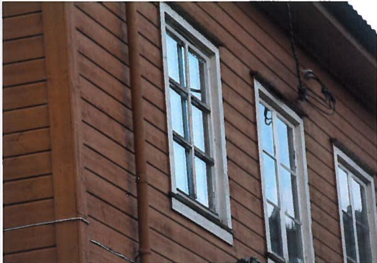
Vinduet lengst til venstre har såkalt falske sprosser. Det midterste og det til høyre er originale. Bilde: Byantikvaren.
