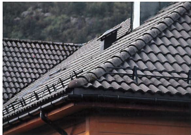
Taket var opprinnelig tekket med skiferstein. I dag er det betongstein på taket. Bilde: Byantikvaren.
