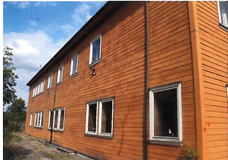
På fasaden i vest har erådringer brutt den opprinnelige rytmen og symmetrien. De tre dørene er bygget igjen. Bilde: Byantikvaren.
