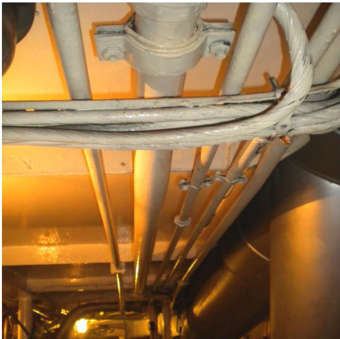
Alle røyr har ein funksjon....
