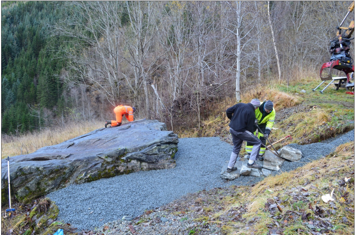
Etablering av ny trapp i grusmassar lagt i skråninga opp mot snuplass/rasteplass. Det vart gjort skjøtsel av bergflata. Foto: HFK
