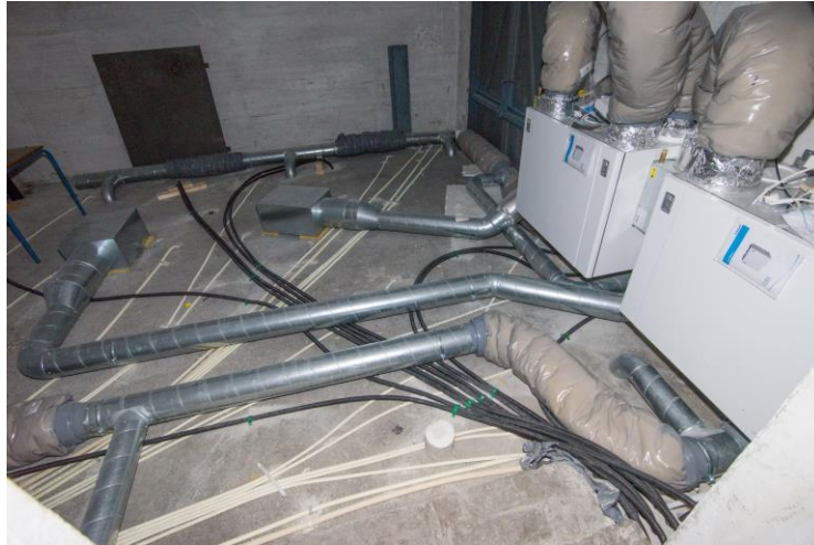
Ventilasjonsanlegget og el installasjon i rommet over
