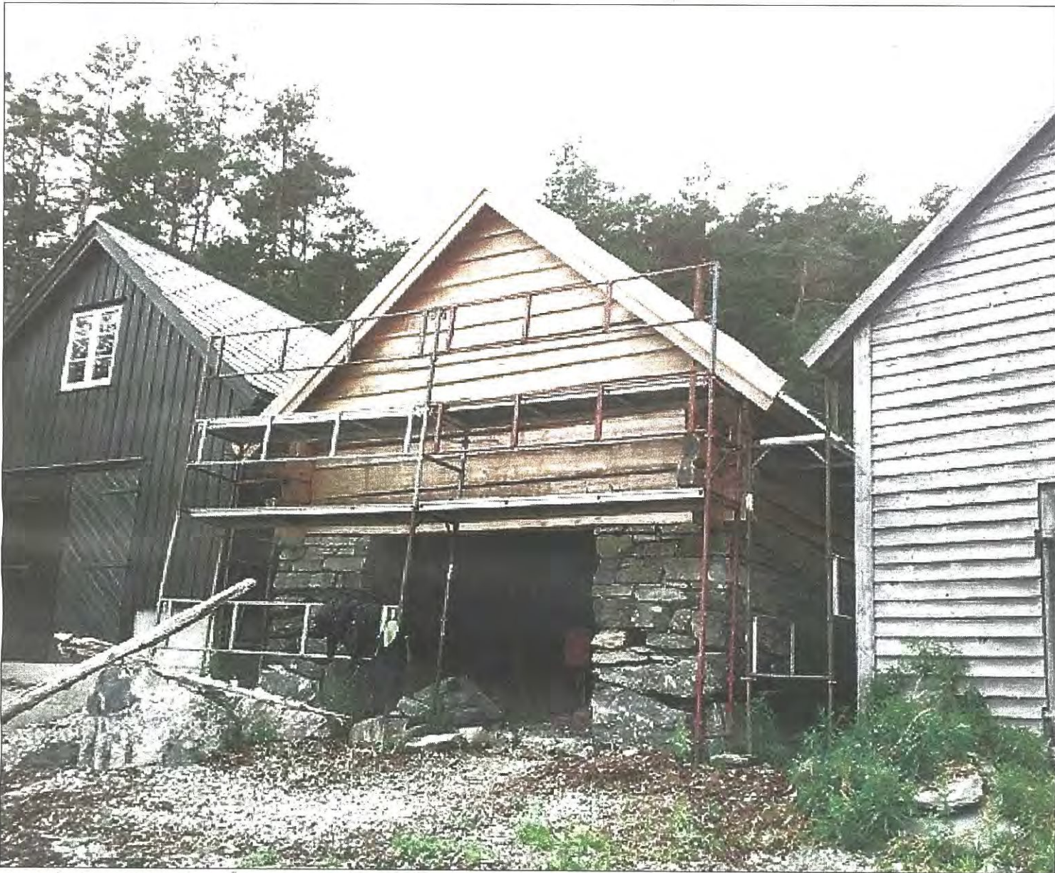
KONTROVERSIELT NAUST: Rektor ved Norheimsund VGS fikk 5000 kroner i bot for ikke å ha bygget i henhold til innvilget søknad. Syv elever ved skolen hans var med på byggingen.
