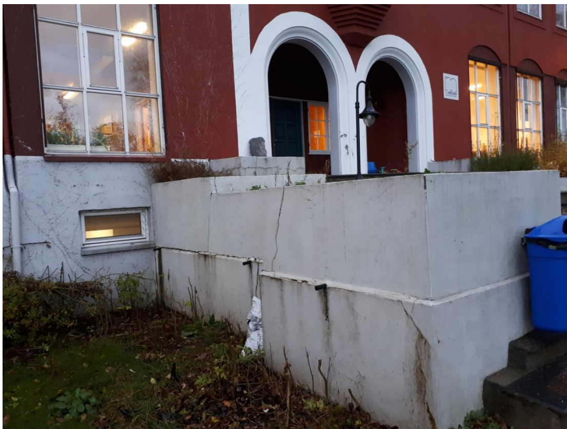
Ved trapp og hovudingang. Sprekker i betongen.
