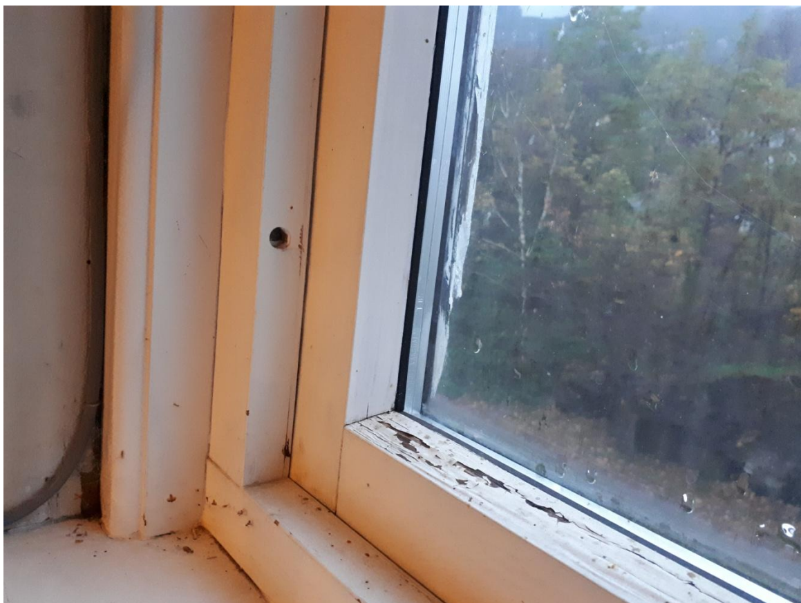
Utvendig oppsmuldring av treverket.
