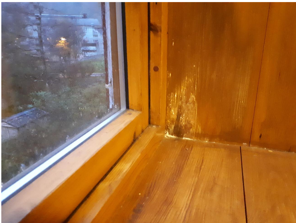
Utvendig og innvendig rote i vindauge i trappegang.
