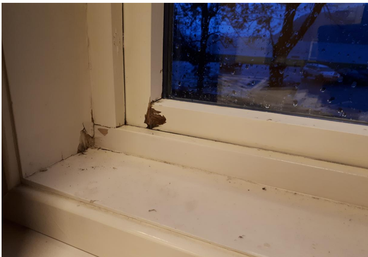
Litt avskalling av maling innvendig på nokre vindaugo i 1. og 2. etg.
