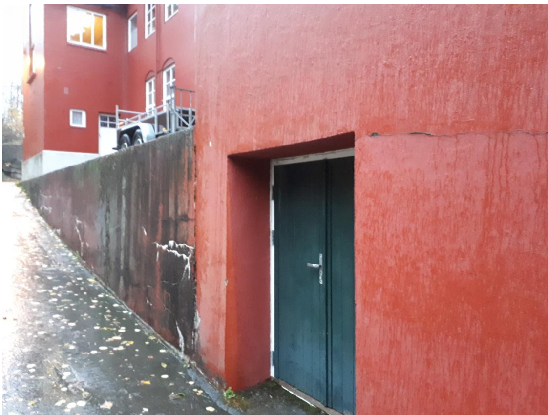
Sprekker i muren.
