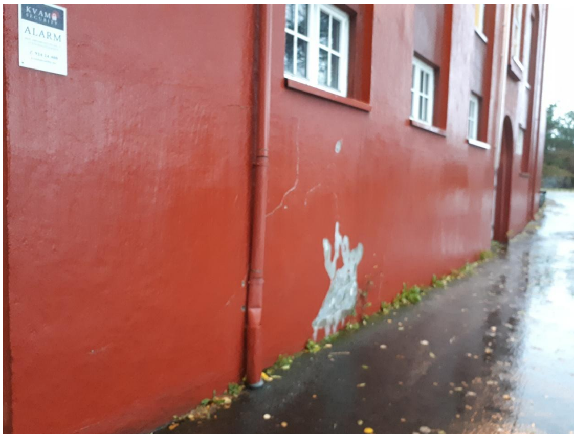
Starting av sprekker og avflassing.
