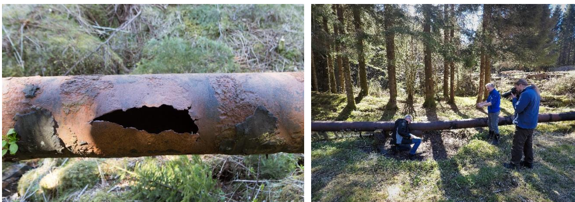
Skadane på røyrgata er ikkje vanskeleg å oppdaga. Foto: Dag Endre Opedal og Knut Markhus/NVIM
