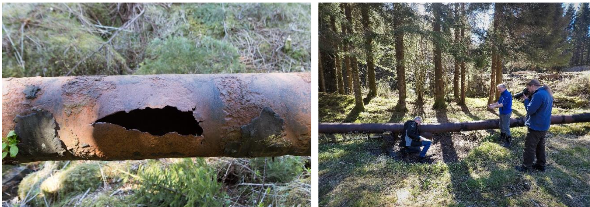
Skadane på røyrgata er ikkje vanskeleg å oppdaga. Foto: Dag Endre Opedal og Knut Markhus/NVIM
