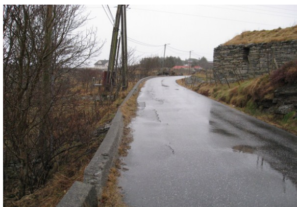
Svært låg støypekant - Breivik
