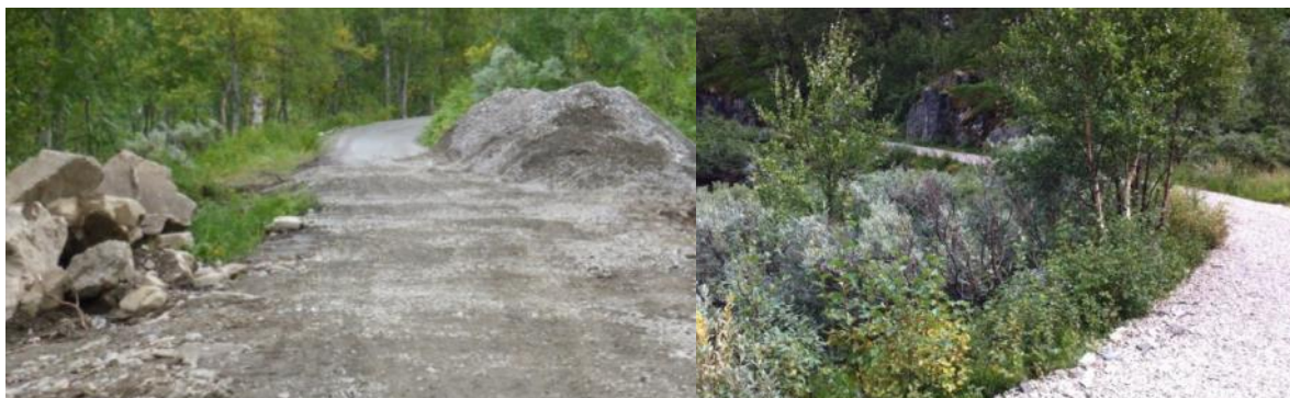
Tv: Knust stein i deponi på høgresida av vegen. Th: Tilført anortositt grus, eit
