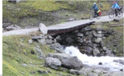
Th: Overbelasta bjelkebru.
