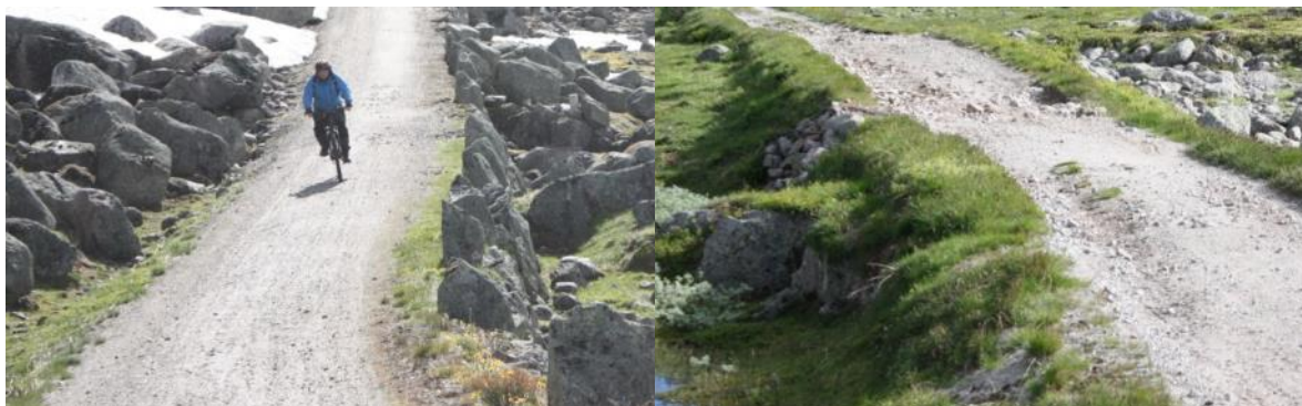
Tv: ved Lågheller. Th: Dårleg stikkrenne og utvasking.
