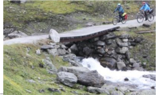
Th: Overbelasta bjelkebru.
