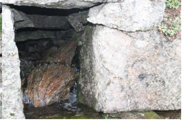
Th : Døme på kollaps.
