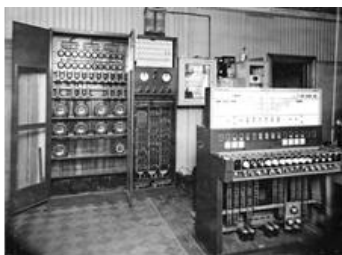
Figur 1 Sikringsanlegget Nesttun st. 1932.
