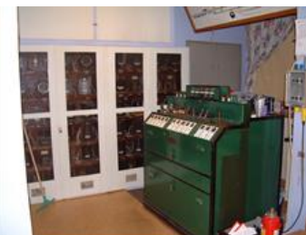
Figur 8 Sikringsanlegget på Spikkestad stasjon i 2002. Foto: Finn Gundersen
