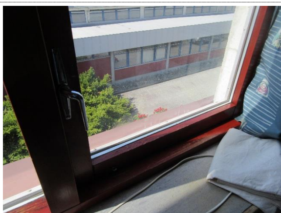
Bilde nr. 17 Gamle trevinduer utgjør ca. halvparten av vinduene.
