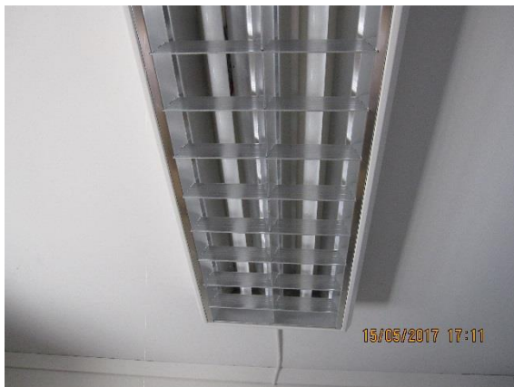
Bilde nr. 27 Paviljong: Eksempel på belysning av eldre dato som anbefales skiftet.
