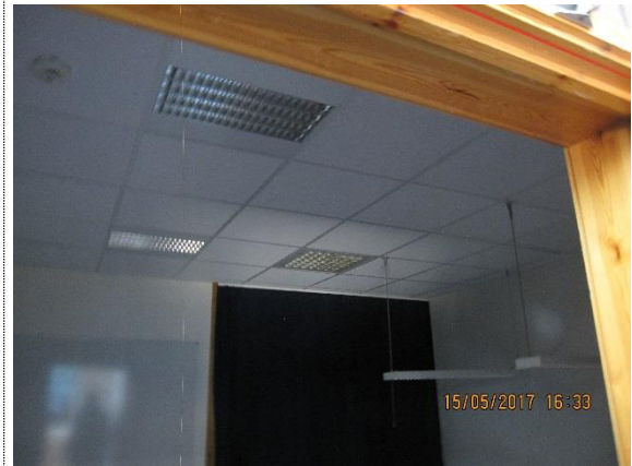
Bilde nr. 26 Verkstedbygg: Eksempel på belysning av eldre dato som anbefales skiftet.
