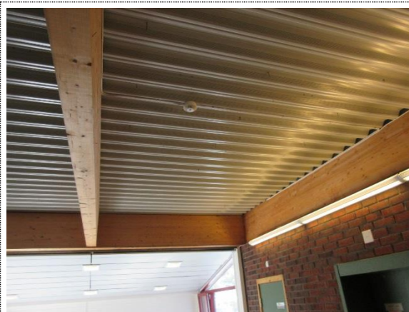
Bilde nr. 14 I 3. etasje er himlingen åpen opp mot ståplatene i taket.
