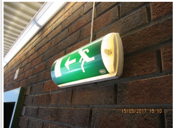
Bilde nr. 28 Hovedbygg: Eksempel på nødlis av eldre dato som anbefales skiftet.
