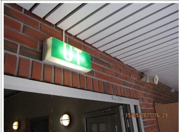
Bilde nr. 30 Verkstedbygg: Eksempel på nødlis av eldre dato som anbefales skiftet.
