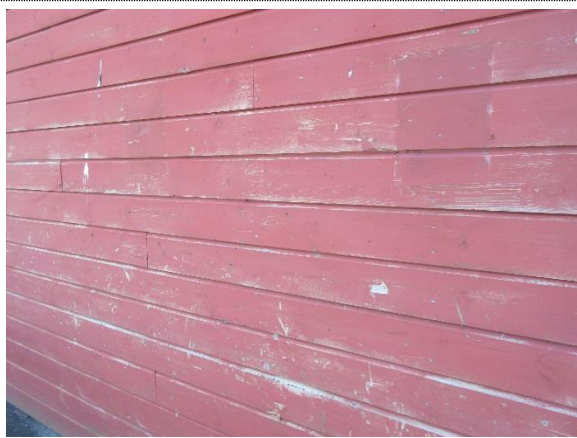
Bilde nr. 5 Mye av panelet bærer preg av manglende vedlikehold.
