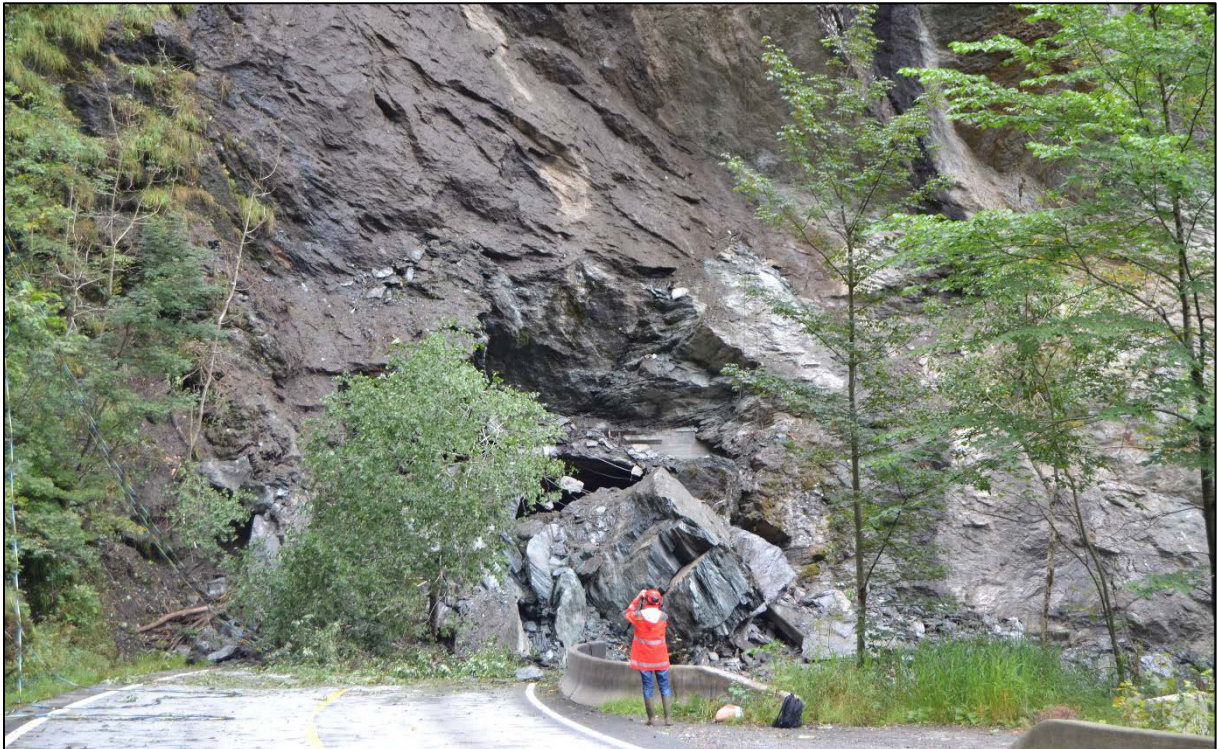
Figur 2: Skred som gjekk over den nordre portalen til Snauhaugtunnelen, 16. september 2013. Liv og helse gjekk ikkje tapt, men vegen vart heilt stengt i ein månad (foto: Mari Åmellem Brøto, Statens vegvesen)
