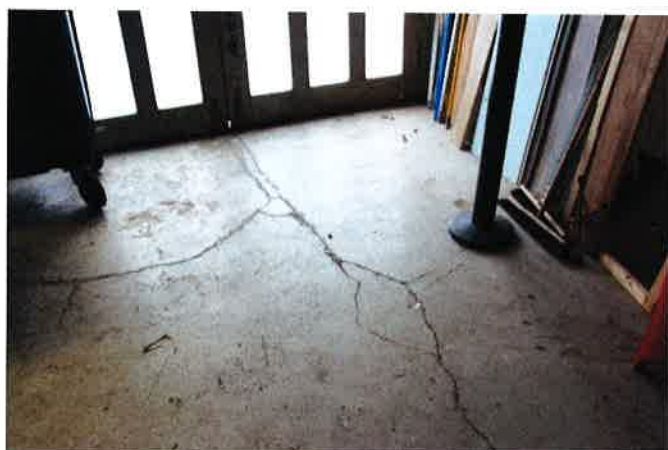
Sprekker i gulv rom 104
