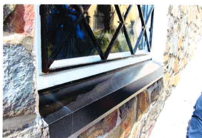
Feilmontert beslag under vindu (nytt vindu) fasade sør
