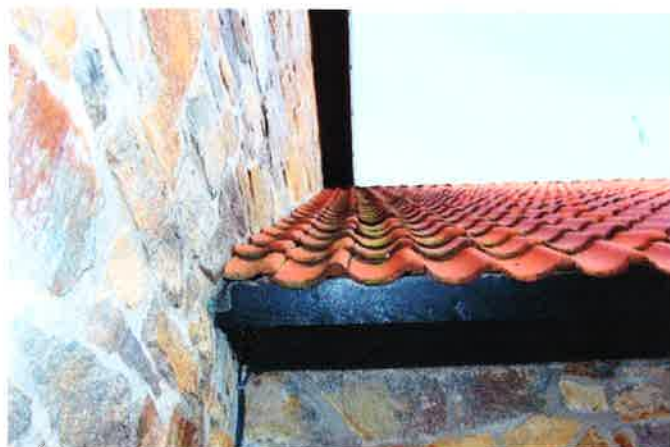
Skottrenne inn mot vegg full av smuss på tak over hovedinngang
