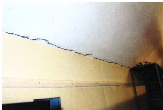
Sprekk i overgang vegg og tak rom 302
