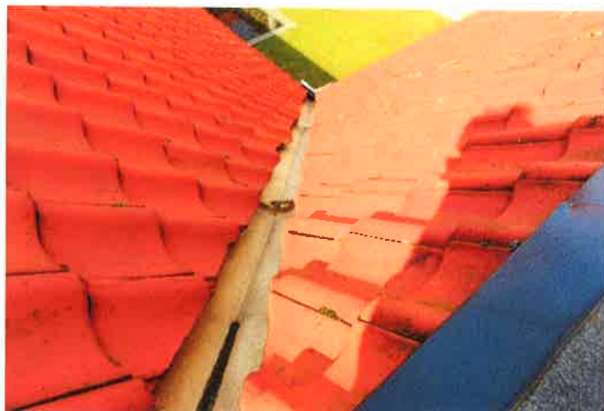
Korrosjon på sløysebeslag
