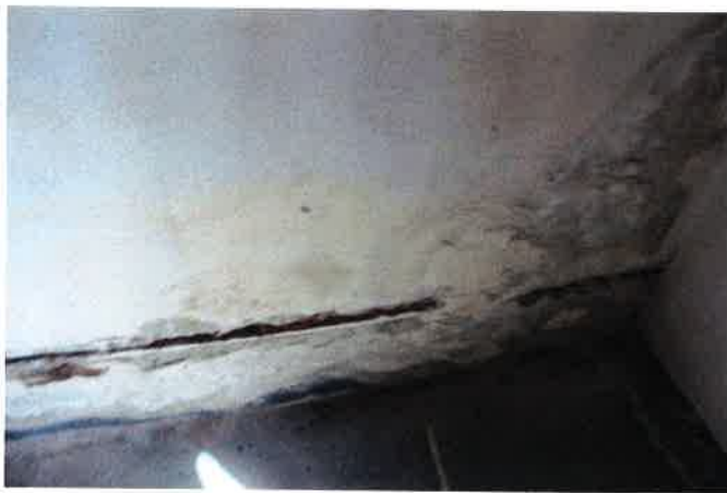
Fukt nedre del av grunnmur
