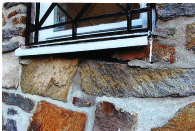
Dårlig beslag og tetting under vindu fasade sør på administrasjonsfløyen
