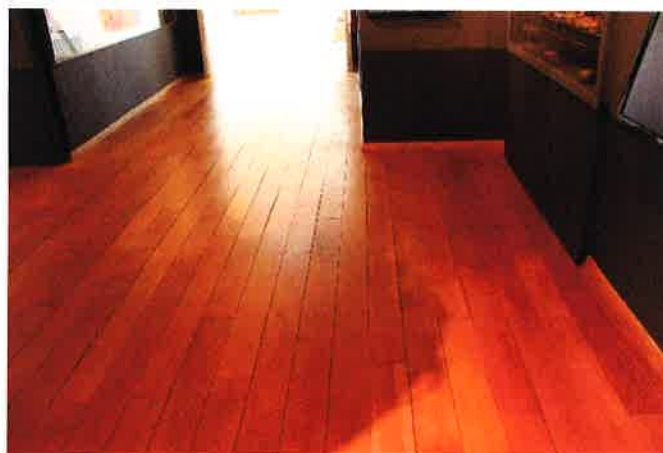
Oppsprukket gulv samlingene rom 219
