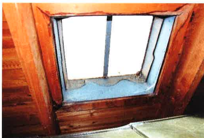
Eldre takvindu med sprekk i glass rom 305
