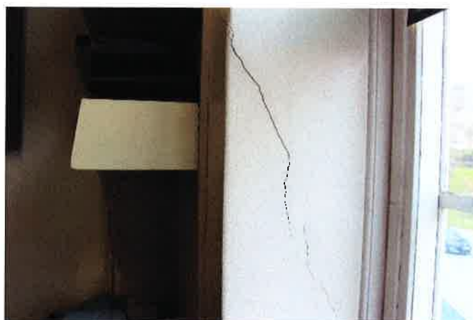
Sprekk i vegg ved vindu rom 202
