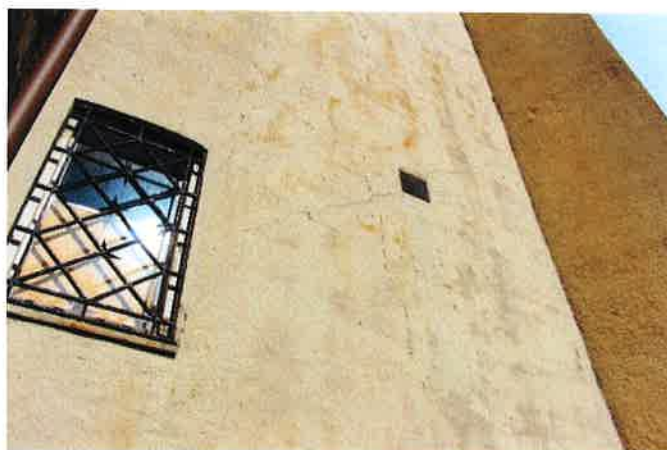
Oppsprukket fasade fasade vest på bygg inn mot nabo i sør
