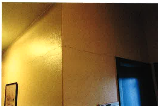
Langsgående sprekk gang rom 220
