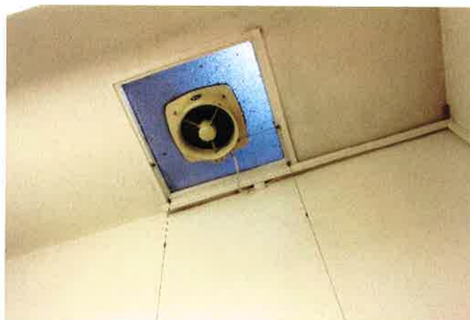
Avtrekksvifte i tak på kjøkken rom 211
