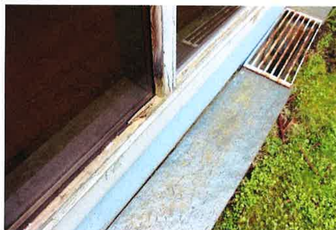
Råteskader på vindu i gårdsrom
