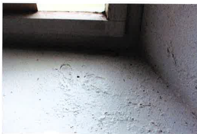
Fuktgjennomslag rundt vindu rom 115
