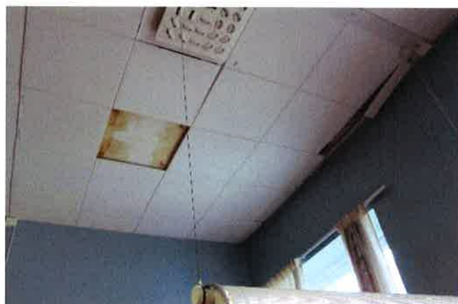
Løse og manglende takplater bibliotek rom 222
