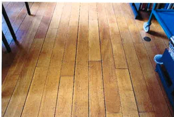
Oppsprukket gulv bibliotek rom 222
