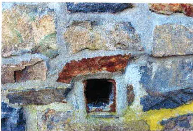
Manglende ventilrist fasade øst på administrasjonsfløyen
