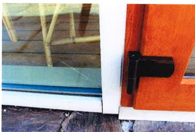
Sprekk i glass (nytt vindu) fasade nord ved utgang til terrassen
