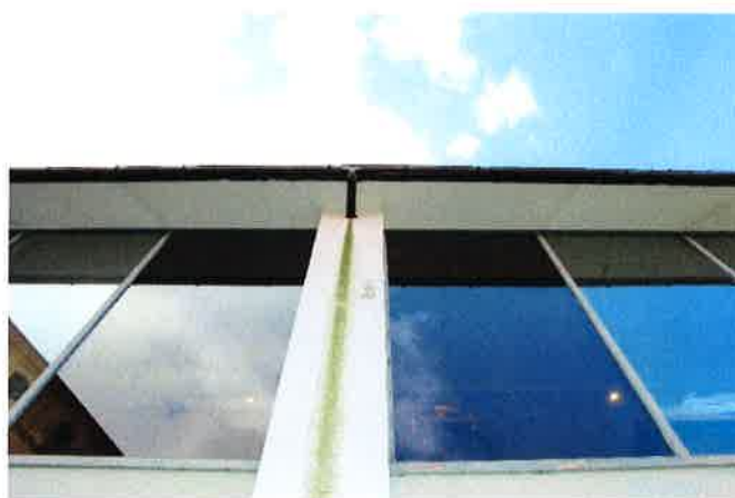
Lekkasje fra takrenne/nedløpsrør i gårdsrom
