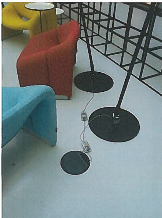
Figur 45 Tilkoblingspunkt i gulv i møbleringssone (foto:L.Aasness)
